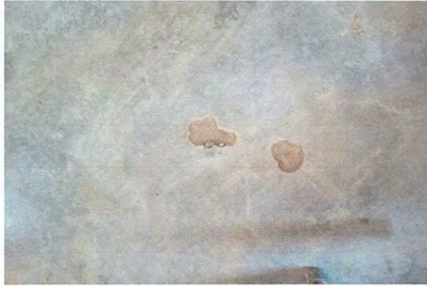
Foto 1: Estado del piso
