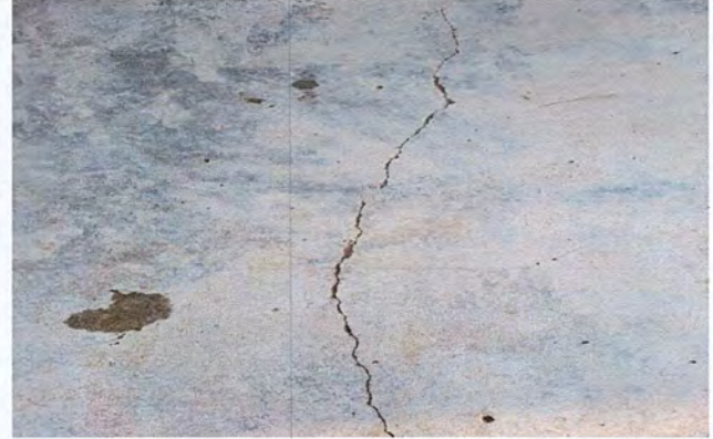
Foto 2: Estado del piso
