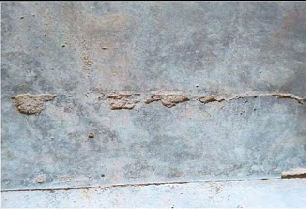
Foto 3: Estado del piso
